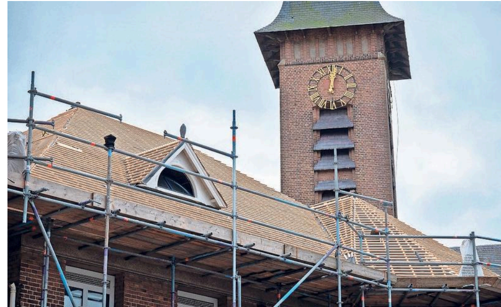
De dakleien op de pastorie moeten worden vervangen.
